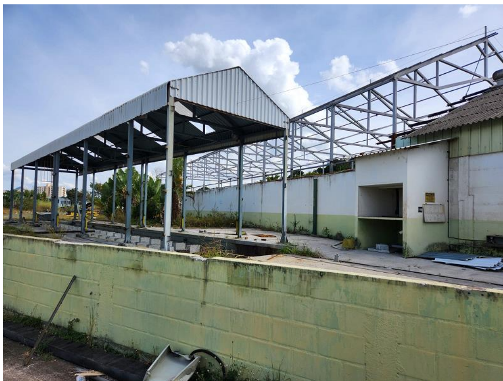
Imagem 7: Galpão secundário em estado de abandono
