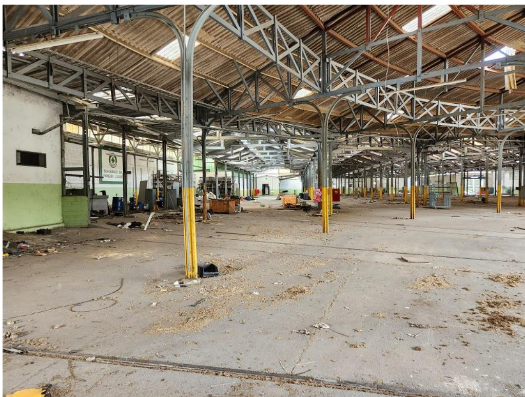
Imagem 2: Galpão principal em estado de abandono
