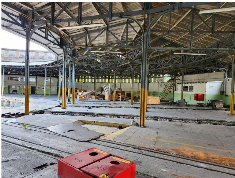
Imagem 3: Galpão principal em estado de abandono
